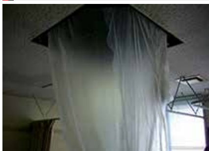
エアコン分解洗浄
