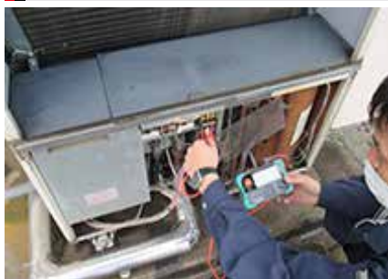
空調機保守管理
