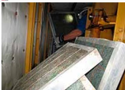
空調機保守管理
